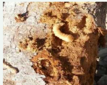
Dégâts larves de Capnode sur bois
